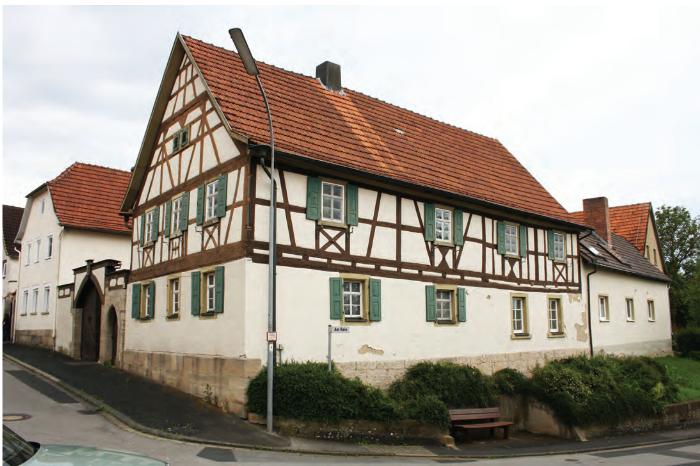
Steiles Satteldach mit Aufschiebling und für Salz typischer Eindeckung mit roten Tondachziegeln
