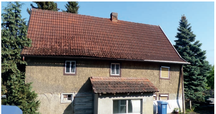
Schlechter Gebäudezustand: Gebäude mit Sanierungsbedarf im Wiesenweg
